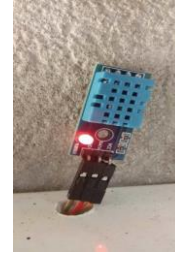
ภาพ 8 แสดงเซนเซอร์ตรวจวัดอุณหภูมิและความชื้นในอากาศที่ติดตั้งภายในโรงเรือนโคนม
