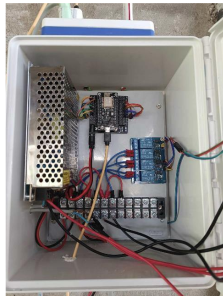
ภาพ 4 แสดงอุปกรณ์ภายในตู้ควบคุม
